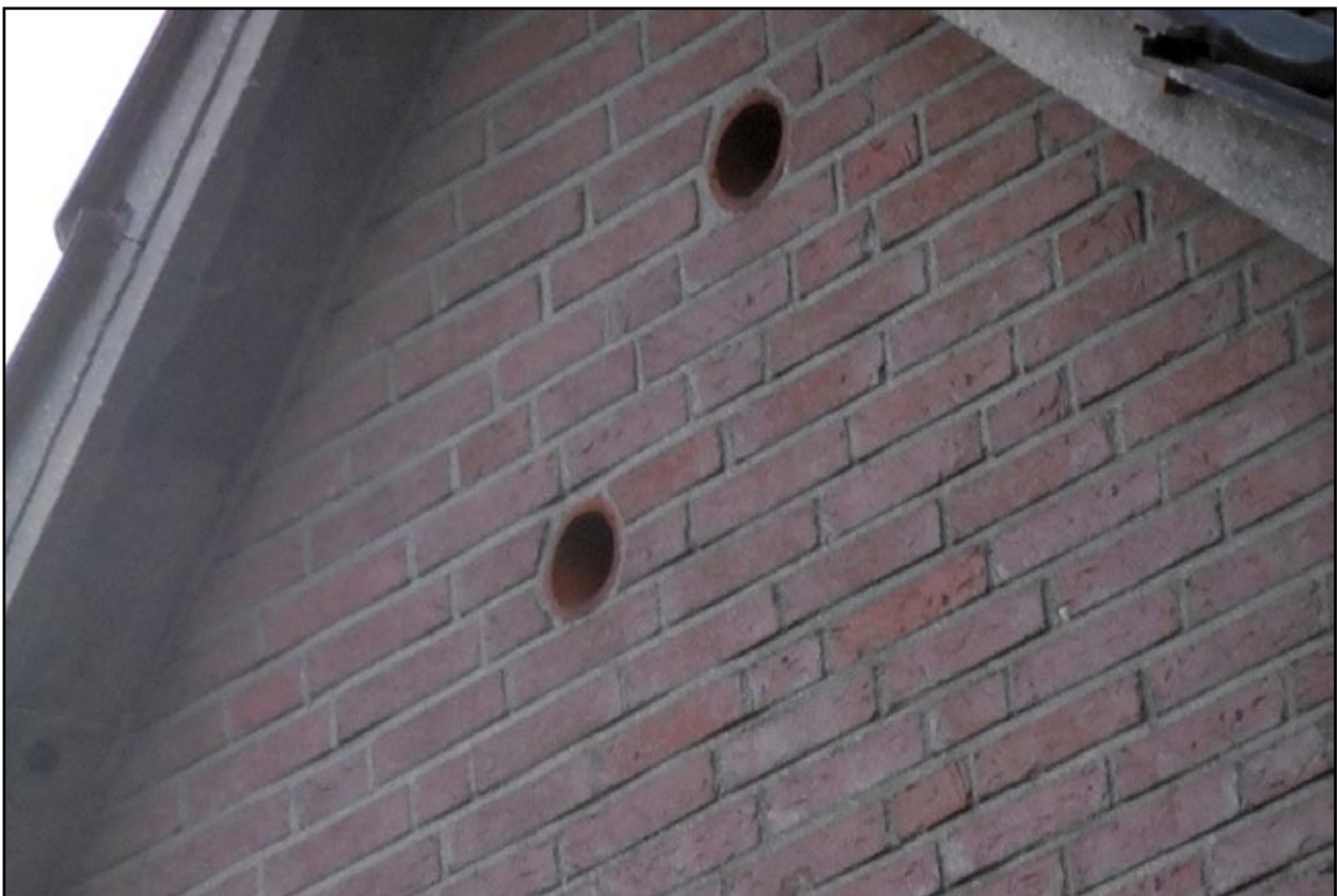
Abbildung 5: An dem bewohnten Gebäude (Flurstück 307) sind im Firstbereich Öffnungen vorhanden.
