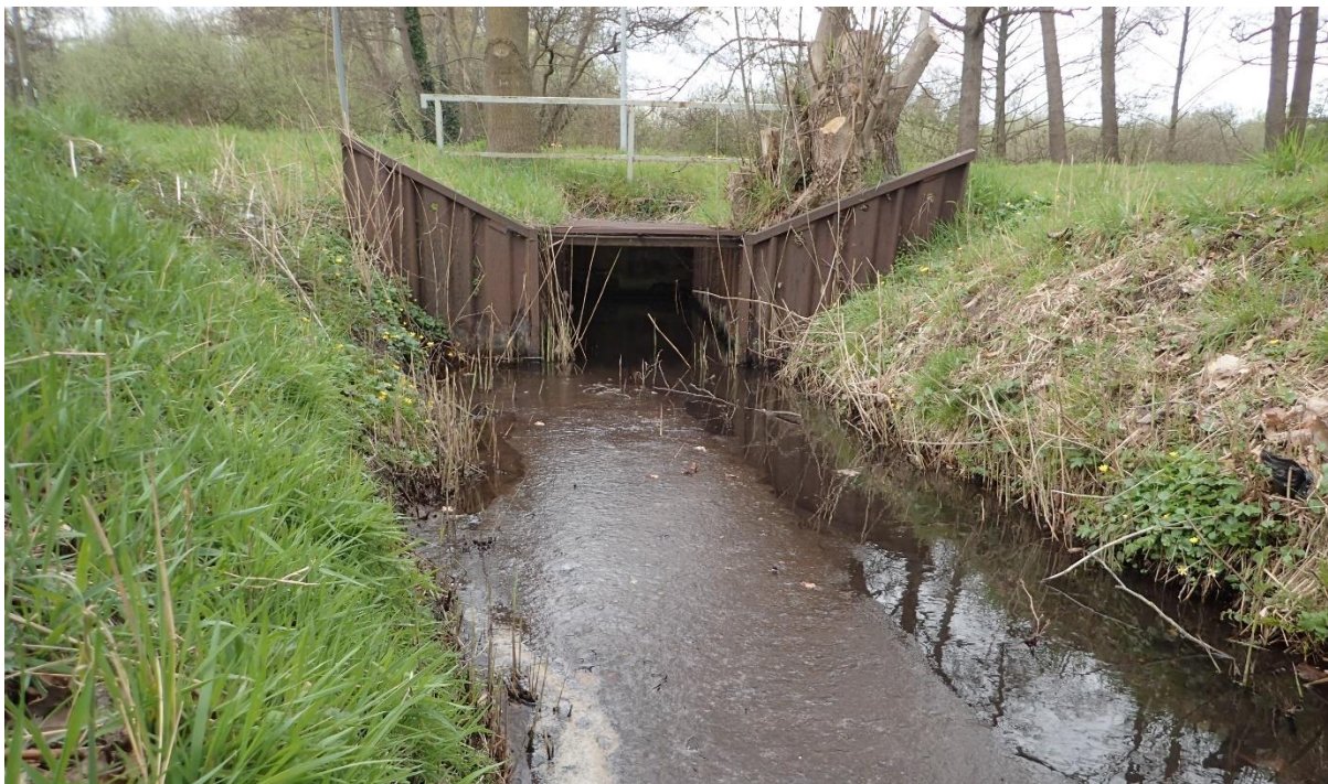
Abbildung 5: Verschlammter Durchlass an der Kreuzung Haferkamp und Mühlenweiher, Ortsbegehung vom 13.04.2022
